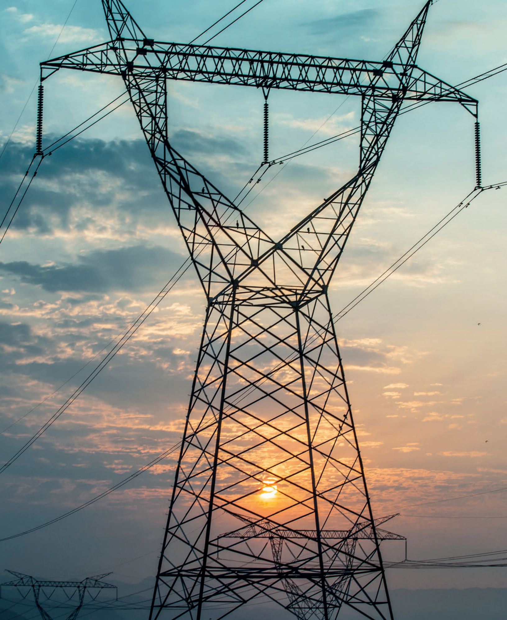
Fotografía 34. Torre de transmisión, Manzanillo, Colima. CFE.
