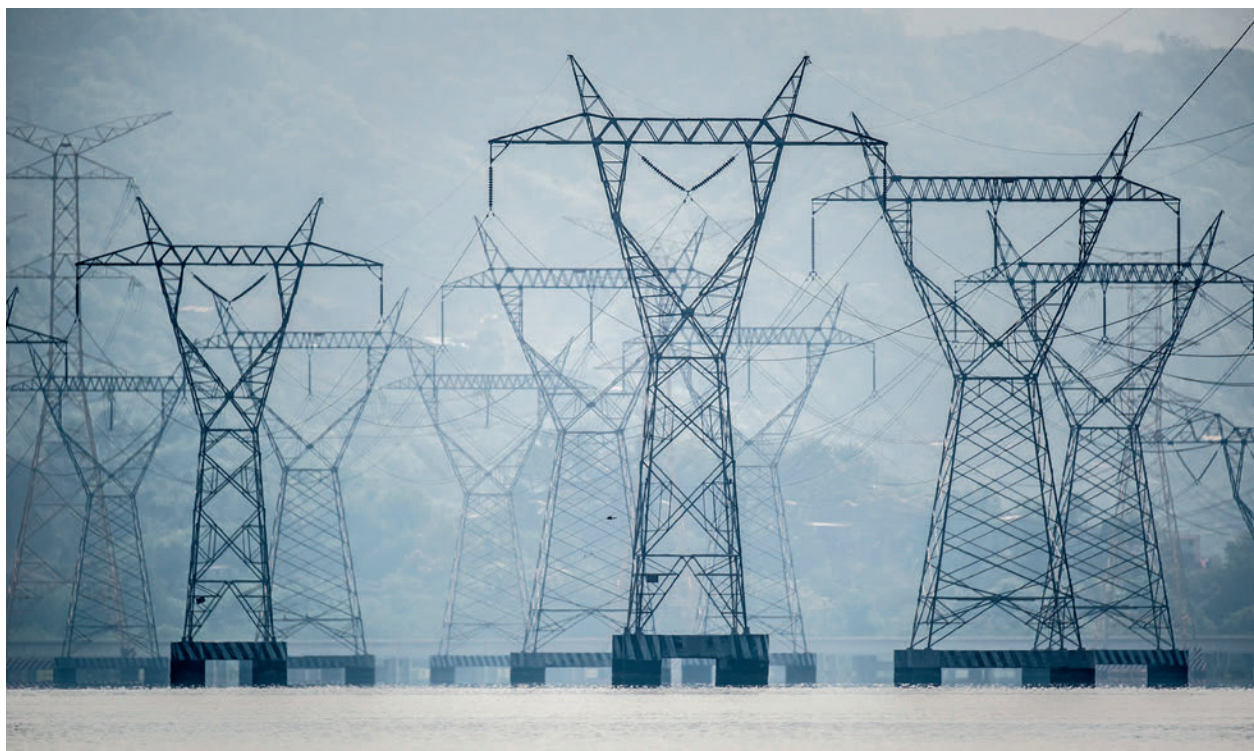
Fotografía 37. Torres de transmisión. Manzanillo, Colima. CFE.
